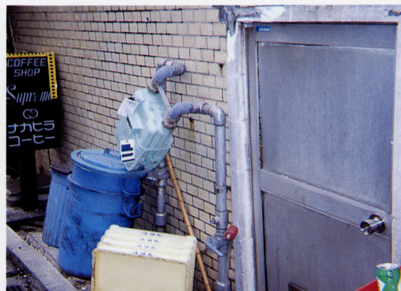
●ネジ継手は漏れの原因になった
