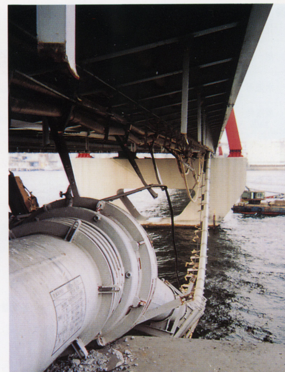
●六甲大橋水道管が落下、伸縮管は著しく変形したが漏れはない
