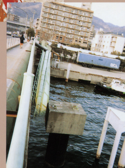
●落下した深江大橋水管橋
