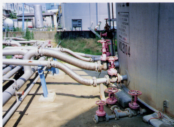
●タンクの沈下600mm、ベローズ形可撓管継手に漏れはない
