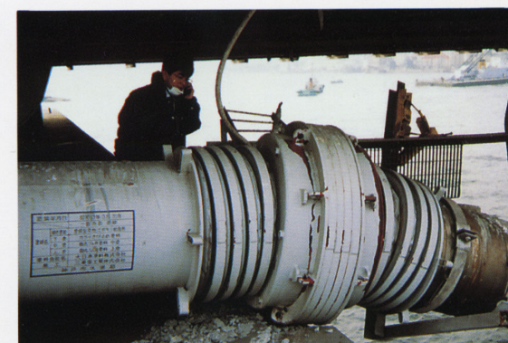
●六甲大橋落下した水道管(700A) 異常に変位した伸縮管、これでも漏れはない
