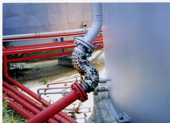
●石油タンクに取り付けられたベローズ形可撓管 これ程曲がっても漏れはない
