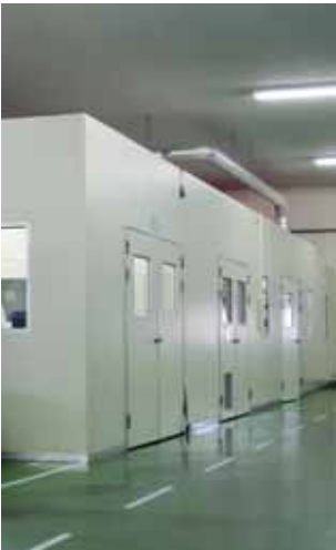
クリーンルーム CLEAN ROOM
